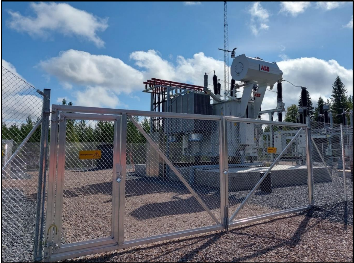
Kuva 4-4. Esimerkkikuva sähköasemasta (Prokon Wind Energy Finland Oy).
